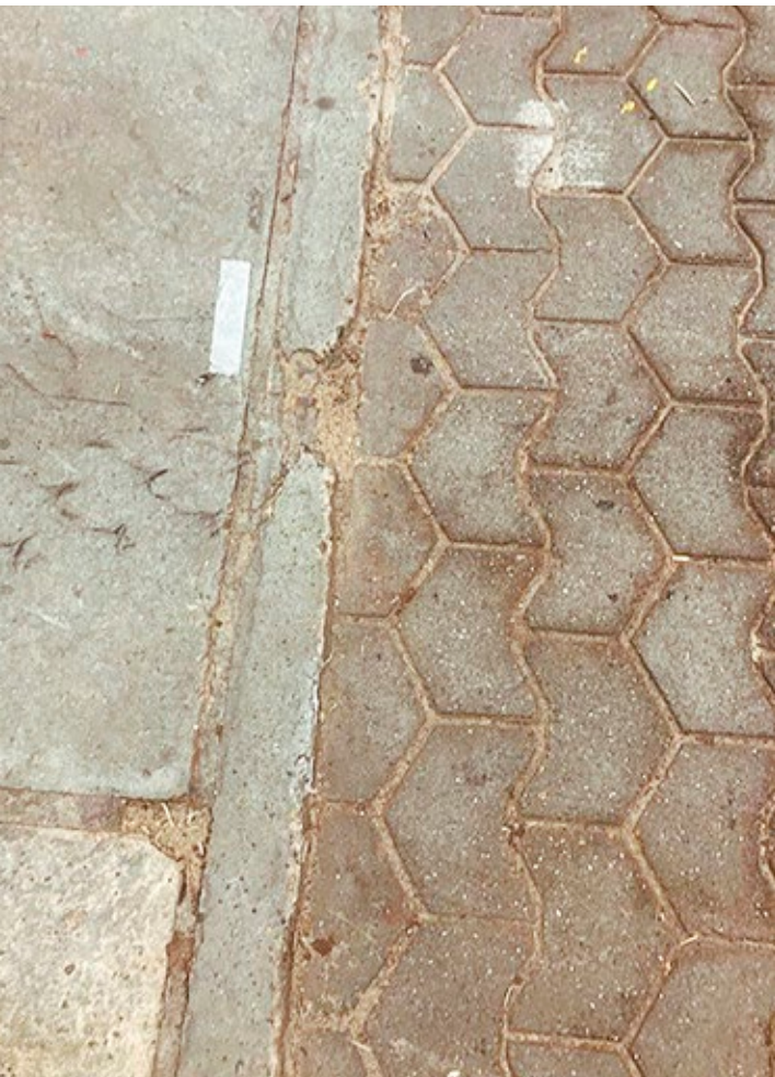
Samtlige garager har ujævne gulve, hvilket ikke er i overensstemmelse med arbejdsmiljøloven, når en truck bliver anvendt. Billedet er fra hal 5.
